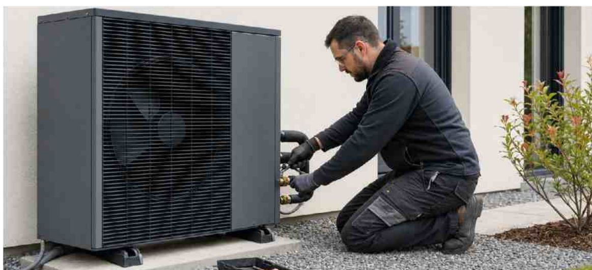
L'installation d'une pompe à chaleur ou d'une climatisation est rentabilisée assez vite. Photo IA
